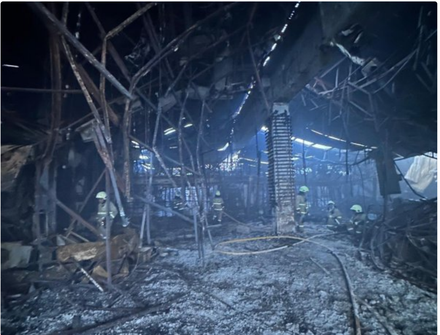
Glodok Plaza yang Hangus Terbakar
